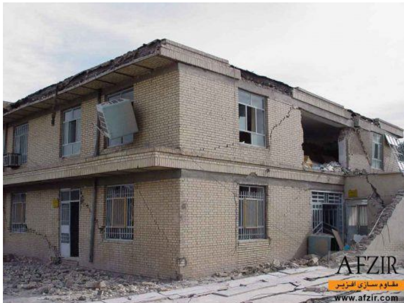
شکست دیوار آجری تحت اثر زلزله
