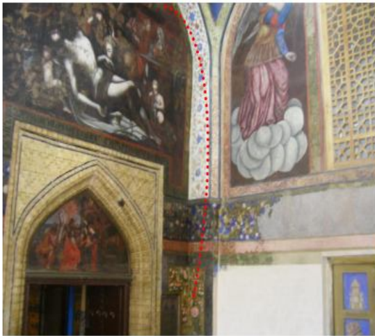
آسیب محل اتصال دیواره محراب به دیوار و سقف گهواره ای
