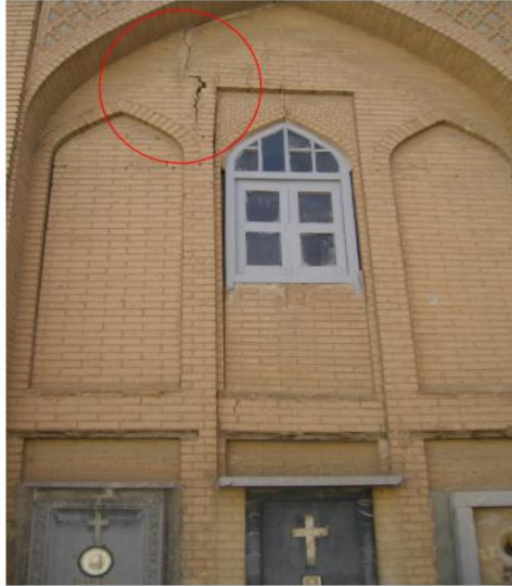
محل اتصال دیوار به سقف گهواره ای و بروز خرابی در اثر تغییر مکان سقف
